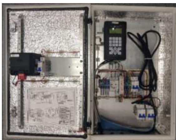
Рисунок 3а) – Общий вид контроллера пылемера СОМ-16.М, смонтированного в металлическом корпусе с системой обогрева
